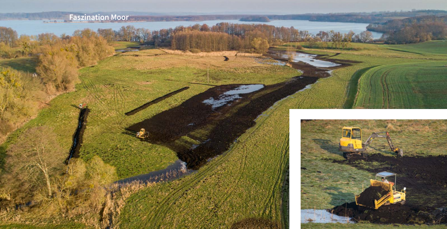
Am Südufer der Lieps trugen die Bagger Torfboden flach ab, um damit die Entwässerungsgräben zu verschließen.
